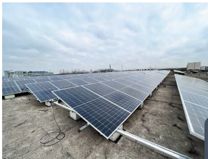
上海尖點太陽能光電設備
