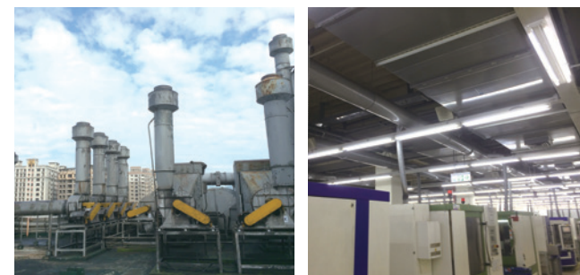
局部排氣裝置、靜電集塵裝置
